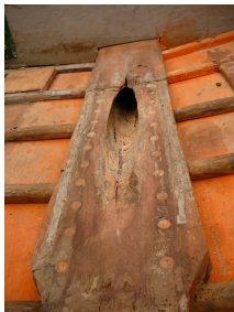
5-Vue de la quille à l'entrée du tube d'étambot après démontage de ce dernier et de la pièce porteuse de la bague hydrolub et du presse étoupe.
