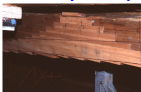
9-Réfection de la quille. D'origine en lamellé collée, la quille était "corrodée" en profondeur au passage ou au contact des pièces métalliques (étrier de fixation du bâti moteur, pièces de fixation des élingues de levage, bande molle).
