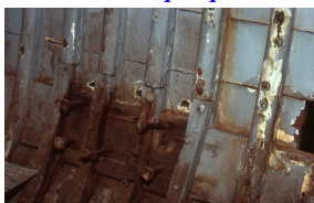
10-Vue des effets de la boulonnerie acier sur la coque et les membrures. À noter que le problème était connu puisque 4 membrures, bien visibles sur cette photo, avaient déjà fait l'objet d'une réparation.
